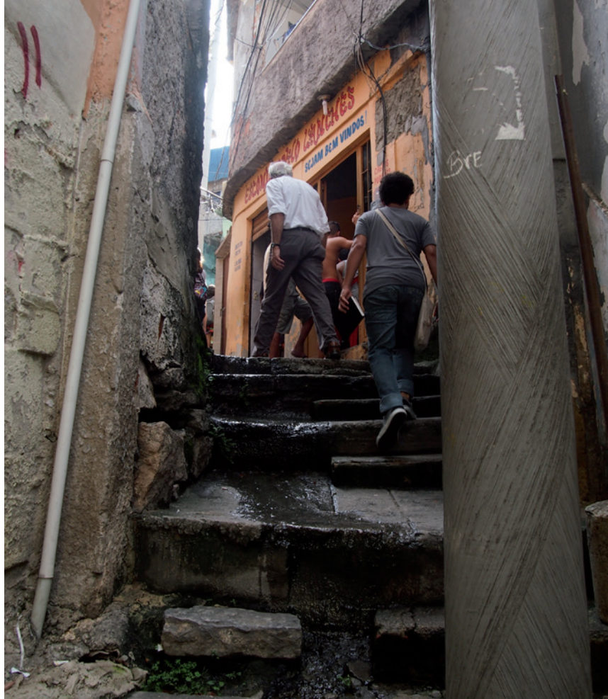
Fig.13: Vazamento de esgoto na Rua Leste. Necessidade de reforma. Foto dos alunos/2015.
